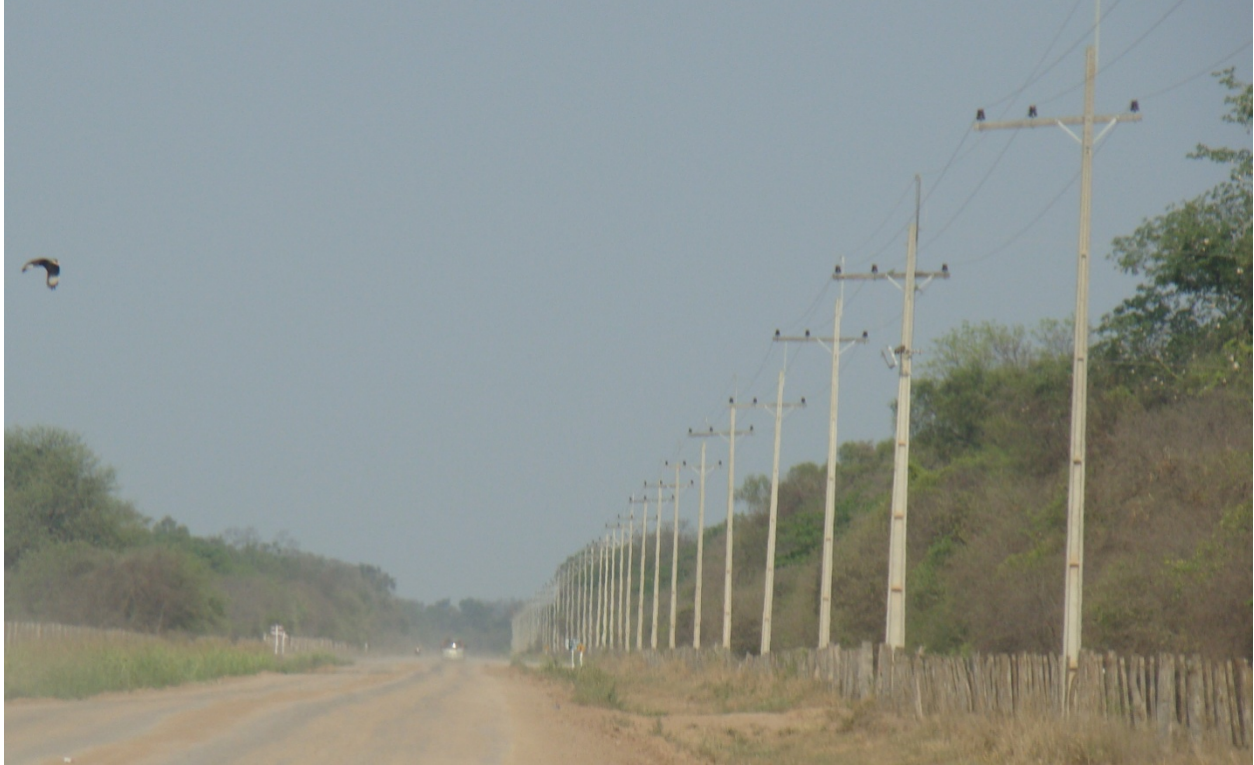
Líneas de transmisión de energía eléctrica.
