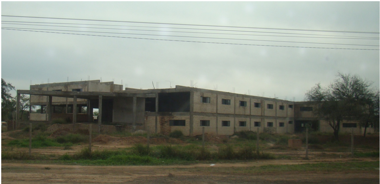
Estado de la construcción del Edificio de la gobernación departamental de Boquerón en Filadelfia, 2010.
