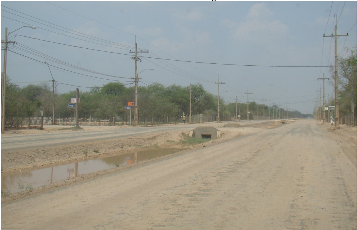
Drenajes pluviales, Ciudad de Loma Plata.
